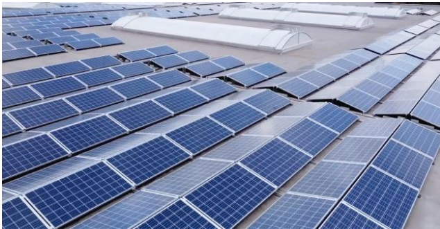
Photovoltaik-Anlage auf einer Gewerbehalle. (Quelle: www.energieagentur.nrw )
